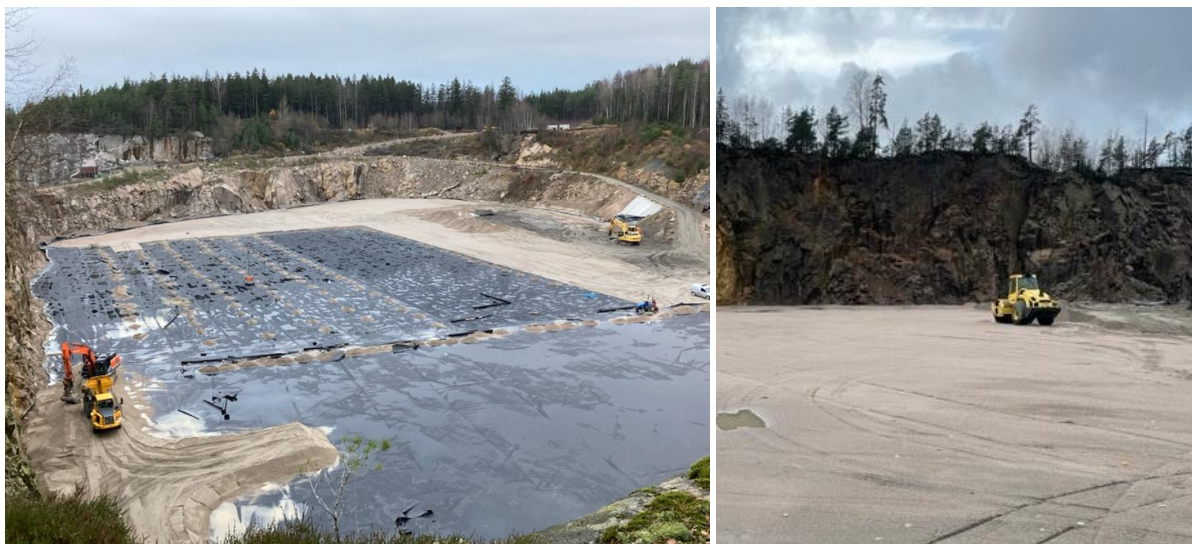
Figur 14: Foto fra avslutning av våtdeponicellen. Venstre: Utlegging av HDPE-membran. Høyre: komprimering av subbus over HDPE-membran med vals.
