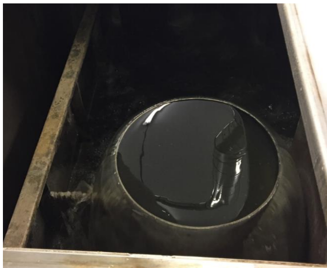
Figur 4: Eksempel på fordelingskasse, Hartevatn RA
