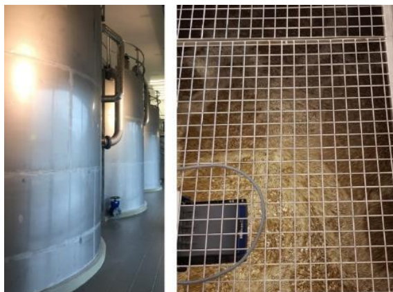
Figur 6: Utvending og innvending bilde av MBBR-tanker i stål. Hartevatn RA
