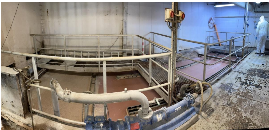
Figur 11. Sedimenteringsbasseng fra innløp til venstre og utløp til høyre. Eksenterskruepumpe i forkant tar ut slam fra slamlomme.
