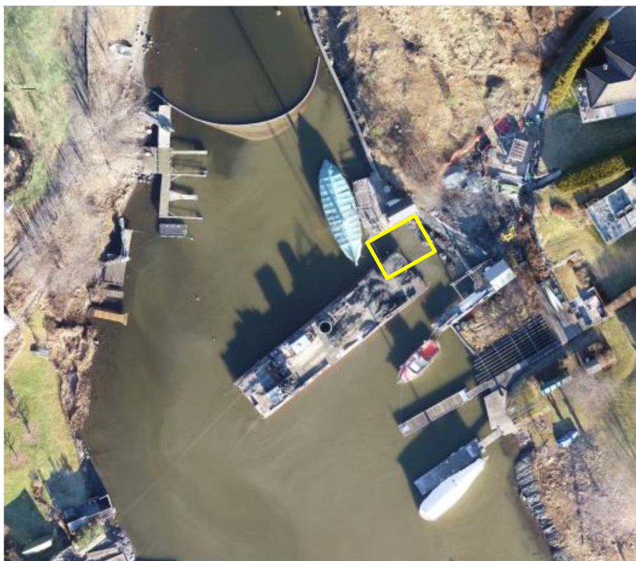
Figur 2-2: Oversiktsbilde av Grønsund under anleggsarbeidene for å legge ned vannledninger på tvers av sundet. Bilde er antagelig tatt med drone. Mudringsarealet er indikert med gul rektangel. Kilde: NIVA
