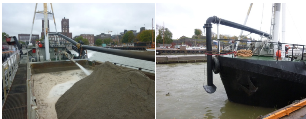
Figur 8 Utlegging av sand med "Rainbowing" fra Arena i Pipervika. Til venstre vises det hvordan det spyles vann inn i lasterommet med dekkmasser for å gjøre sanden pumpbar. Til høyre sees arrangementet med diffusor for "Rainbowing" av massene.
