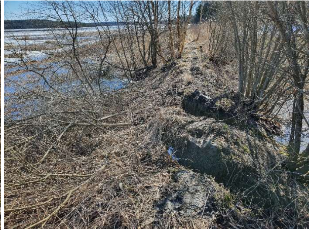
Skader på demning, må repareres fortløpende.
