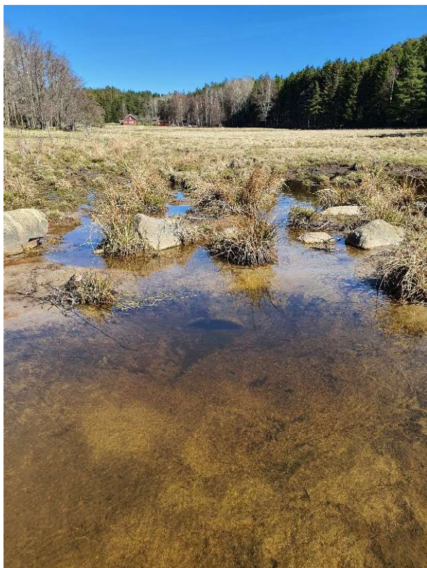
Ødelagt lukkeledning ligger dykket og har ikke utløp
