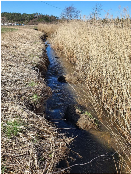
Svake kanter og erosjon fra Husebybekken
