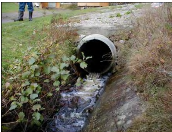
Fig.3 Kulverten/røret ved Slevik Østre hvor ørreten kan ha problemer med å passere.
