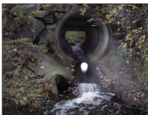
Fig. 5. Mulig oppgangshinder på st. 2.
