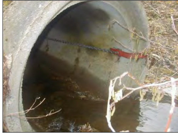
Fig. 3. Innløp til 2. lukking, legg merke til kjettingen m/stein som er lagt inn i røret.
