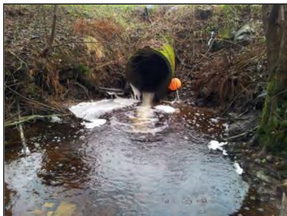
Fig. 12. Røret under veien til campingfungerer som et vandringshinder for fisk.
