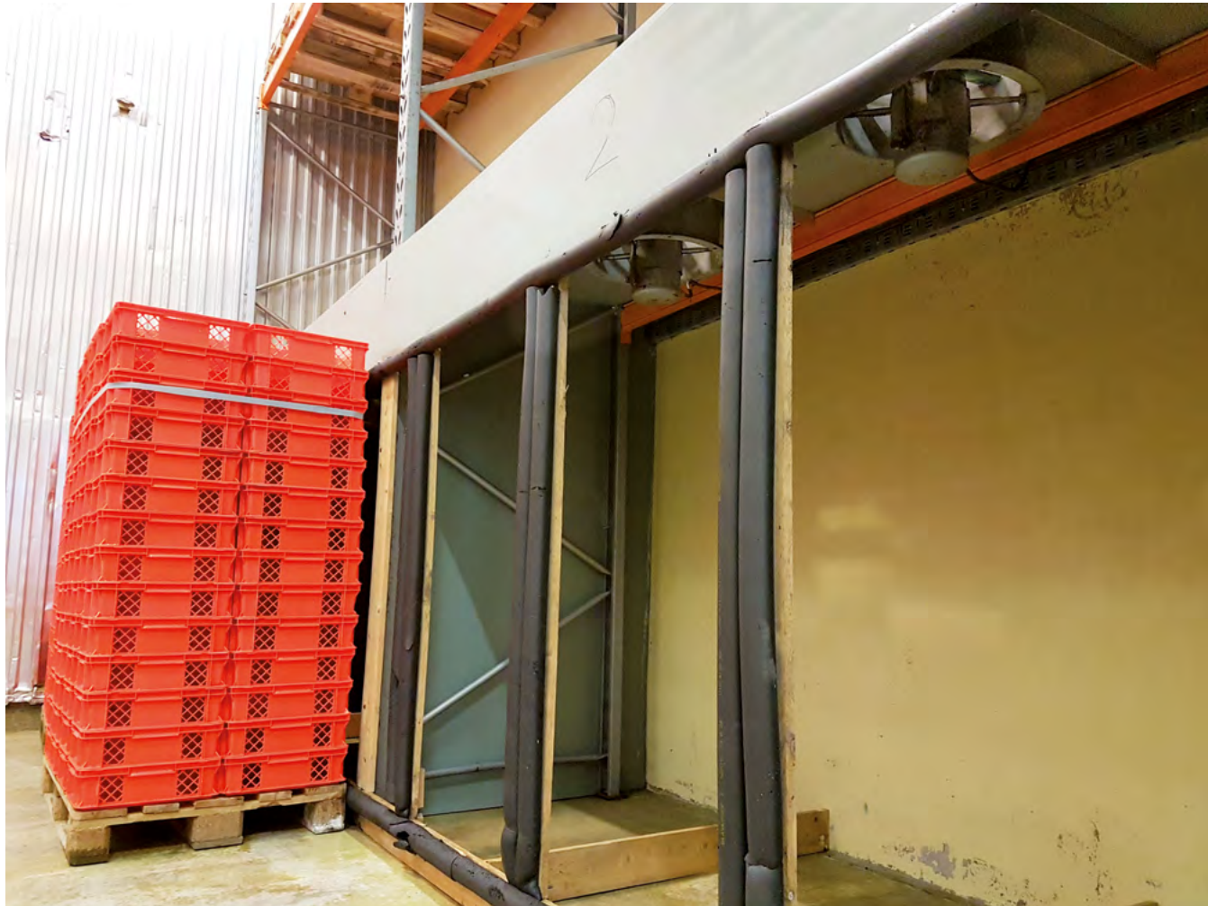
Reol bygd om for tvangskjøling av bær. Viftene er plasserte i hylla i reolen og syg kald luft gjennom pallane.
