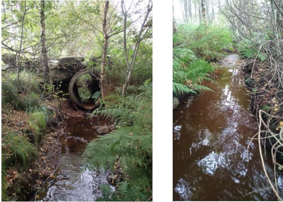
Figur 34. Betongrør under tursti (venstre), utløp til Hålandsvatnet (høyre). Figur hentet fra Molversmyr, Stabell, & Mjelde (2018) figur 7.
