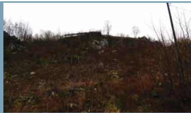
Figur 99: bergskjæring mot vest med større ustabile blokker, Foto: Multiconsult nov. 2014
