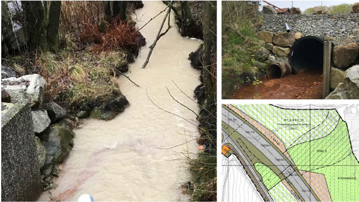
Figur 6-20: Kleivabekken går i rør under dagens E39. Utsnitt fra plankartet viser ny kulvert som skal etableres her. Bekken skal legges om i åpent løp innen hensynssone H560_6.
