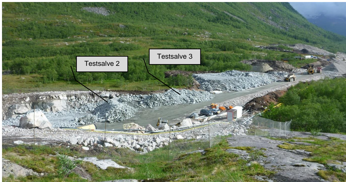
Figur 6: Riggområdet utenfor tunnel for mellomlagring av masser fra de ulike testsalvene. Her vises masser fra testsalve 2 og 3.
