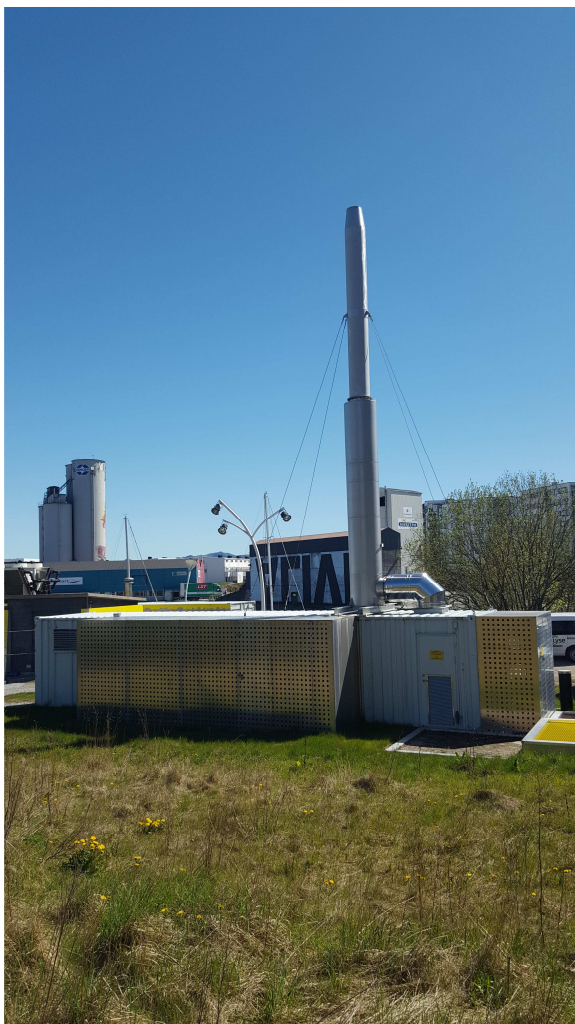
Figur 2 Containersentral 2,7 MW Løvetannparken Eks. skorstein på 12,5 m forlenges til 20 m
