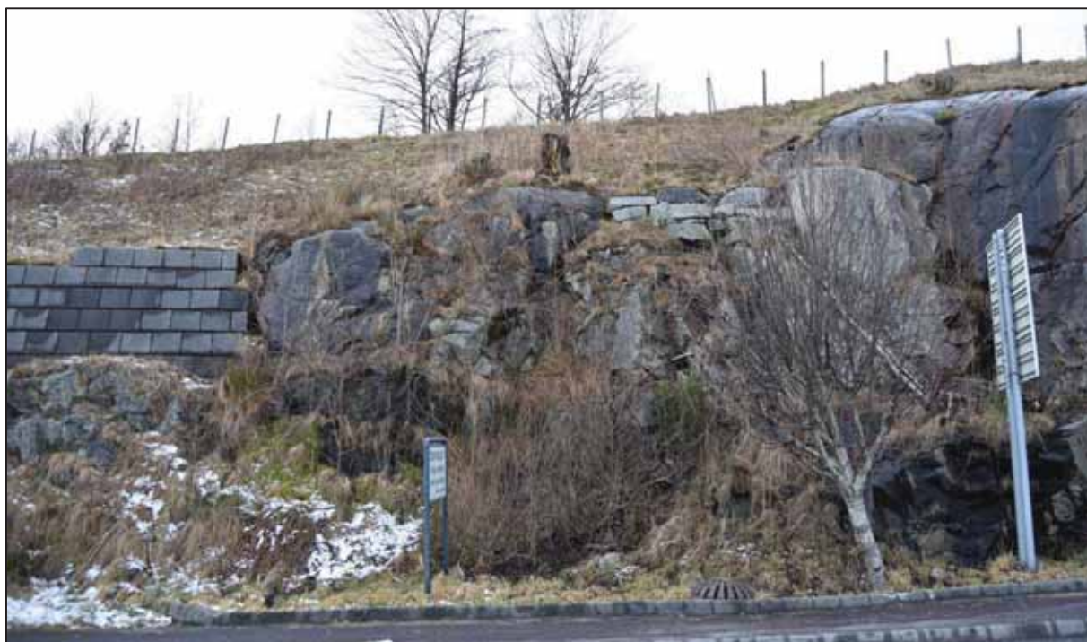
Bilde 9. Den oppsprukne bergskjæringen ved ca. profil 150.
