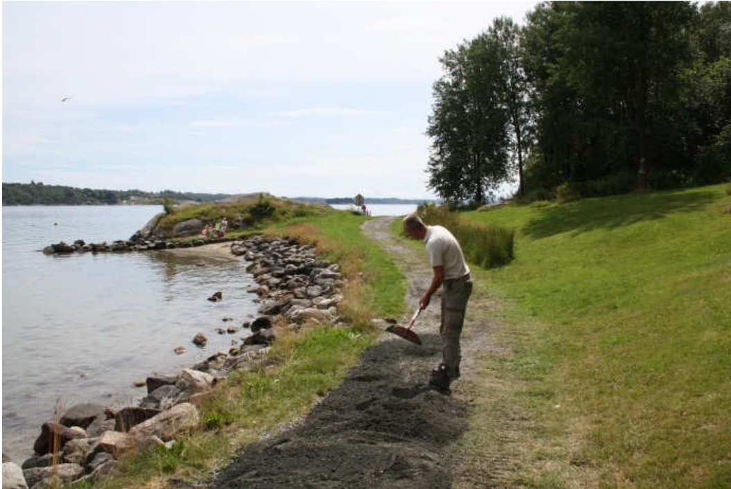
Turvegen gjennom området trenger jevnt vedlikehold
