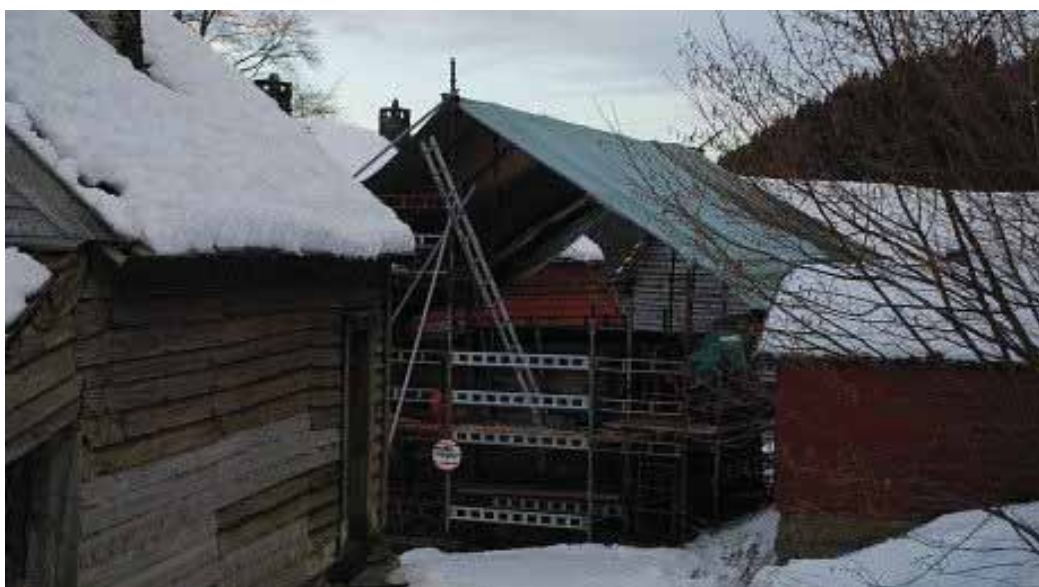
Figur 43: Vigatunet (Ryfylkemuseet) har store røteskadar på bygningane frå 1600-talet (Foto: A.J. Espeland/NRK)
