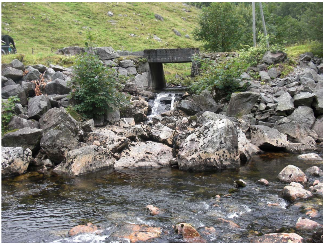
Figur 39. Sannsynlig vandringshinder ved utløpet til Monabekken.
