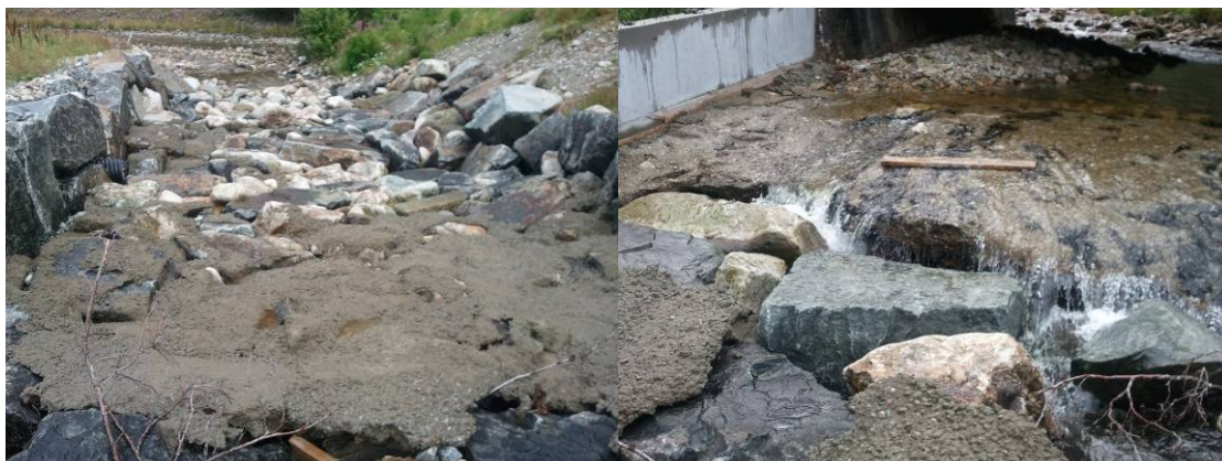
Figur 33. Vandringshinder ved Fv 45 (Dirdalsveien). (Venstre) bilde er tatt nedstrøms fra veien. (Høyre) bildet er tatt oppstrøms opp under broa.
