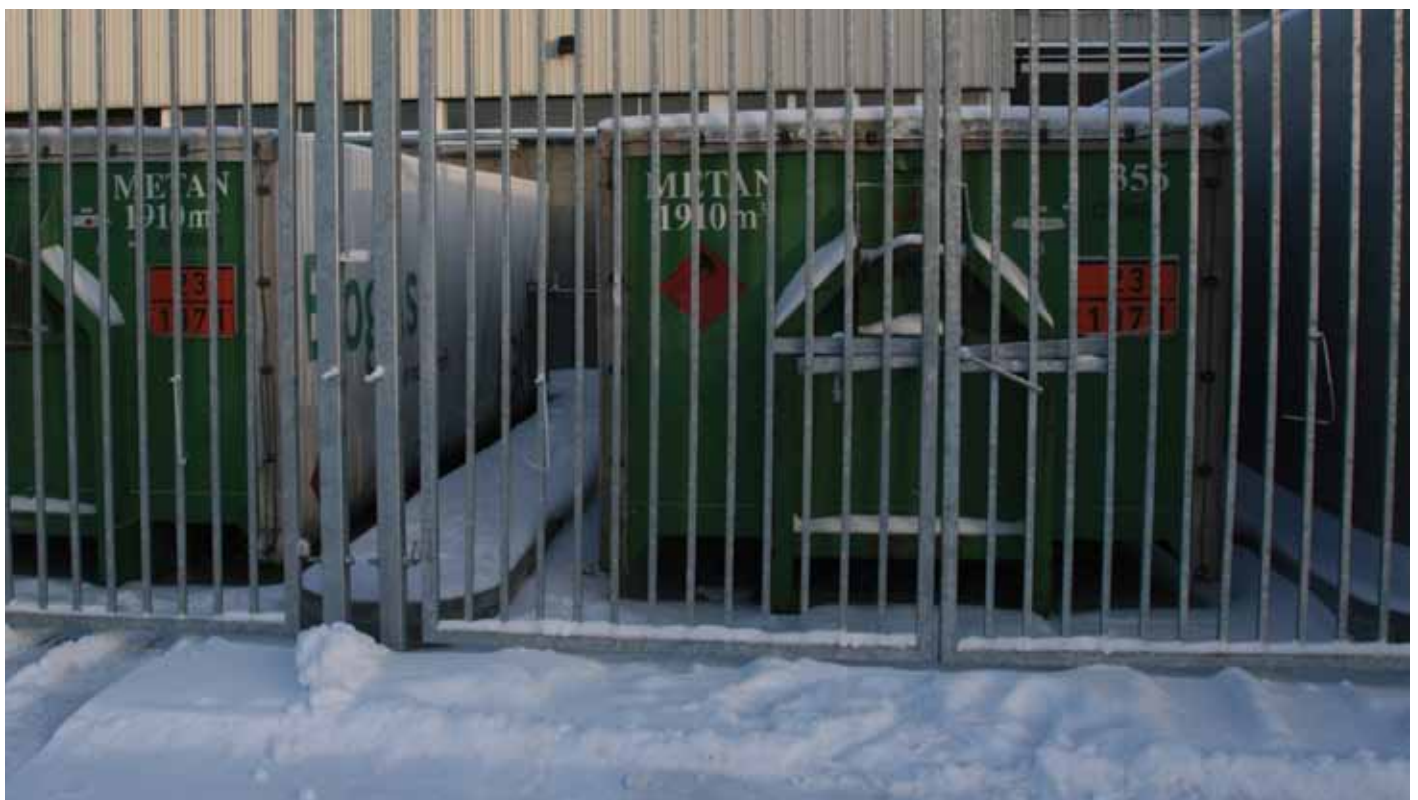
Containerflaket og pumpa til AGA på Alnabru. Foto: TI, Norsk gassenter
