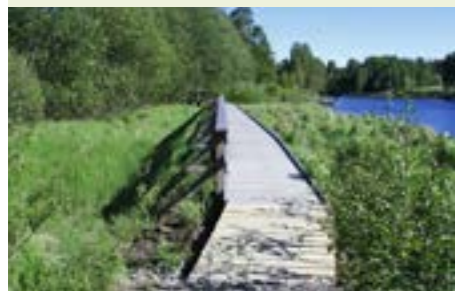
Foto: Øyvind Dahle Brukonstruksjon i vannkanten har stort tverrfall og uoverkommelig nivåforskjell. Ved evt. opprustning /utbygging bør dekket glisikres og håndlist etableres på rekkverk.
