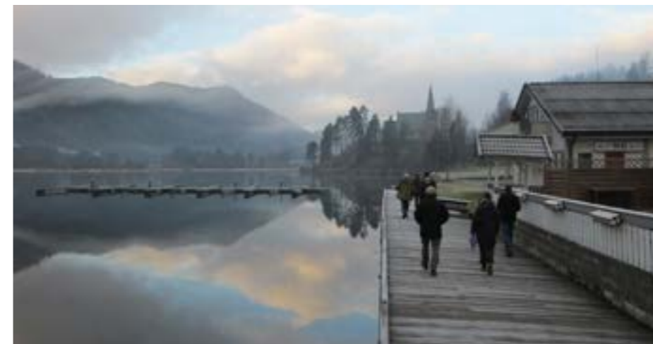
Foto: Roger Jensen Brygga i Kviteseid med kirka i bakgrunn. Brygga er preget av setninger og stort tverrfall.
