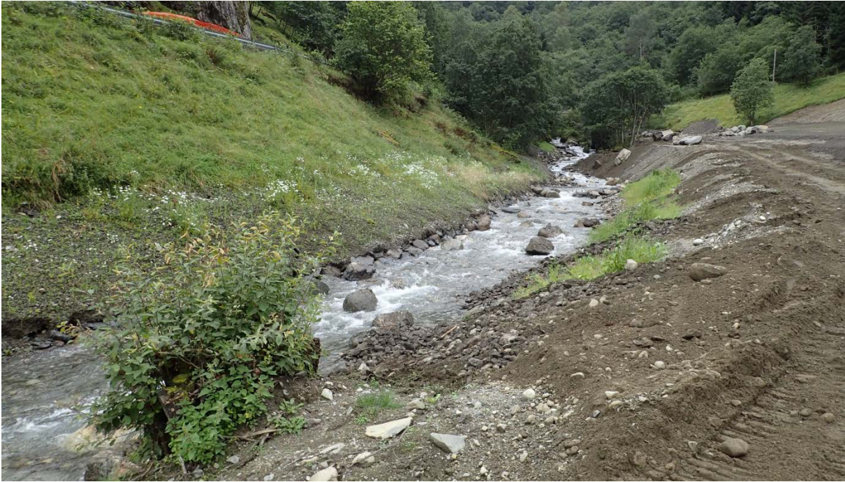
Fig. 11 Fra anleggsområdet Tverrelvi i Flåm 2016 (NVE). Bekken ble fullstendig erosjonssikret med gjennomgående kant- og bunnplastring – men den er knapt synlig. Plastringen er ru og uregelmessig samt at den er satt til side og gravd ned i bakken. Med dette er det rom for naturtypiske elvebredder og substrat i bekken. Kantvegetasjon med stedegen selje og gråor er plantet og alt ligger til rette for en naturtypisk og produktiv sjørrettbekk samt at veien og arealet mot høyre er erosjonssikret.
