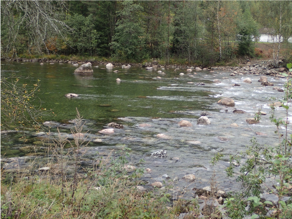
Fig. 16 Bunnstabilisering som reduserer erosjonsrisiko på både elvbunn og elvebredder ovenfor. Tiltaket er utformet som et naturlig brekk – ikke som en terskel. Stabile steiner (egenvekt) er gravd ned i bakken og lagt ut med høy variasjon og ruhet samt en lavvansrenne i midten. Ovenfor er det en gradvis overgang til kulp med gytegrus og stein med varierende diameter.
