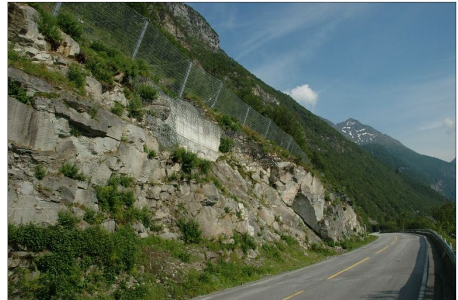
Figur 4-19. Eksempelbilde av fanggjerde. Bildet viser 5m høyt fanggjerde ved rv. 70 ved Oppdølstranda. Kilde: SVV_VD rapport 32 Sikring av veger mot steinskred, [20].
